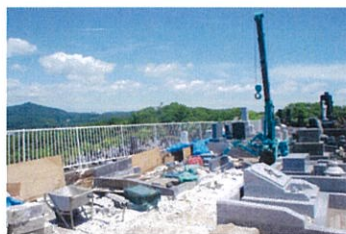
擁壁破損区画一部墓石取外し
